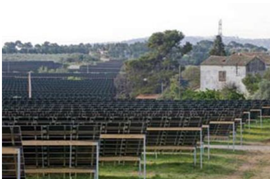
Ombrière de parking photovoltaïques et candélabre autonome
